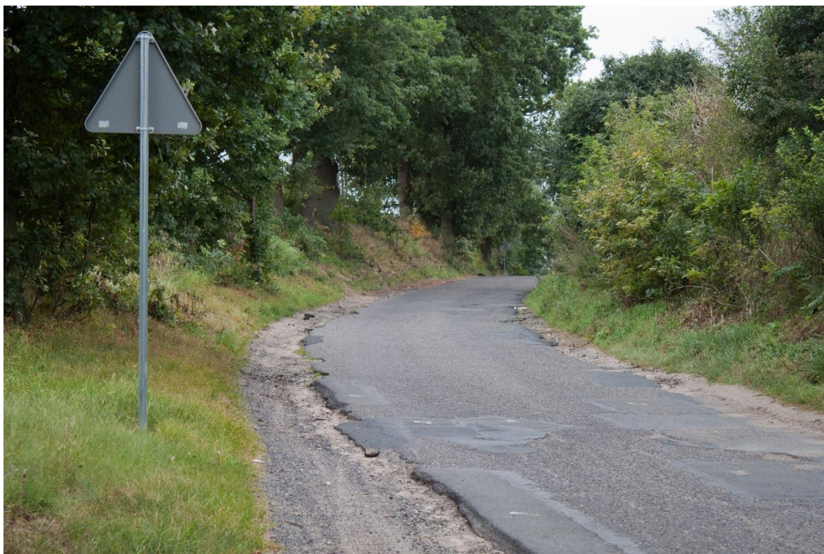
Zdjęcie 11. Stan techniczny drogi na odcinku Buk - Rzędziny. Mieszkańcy wskazują na problem szerokości i stanu technicznego jezdni
